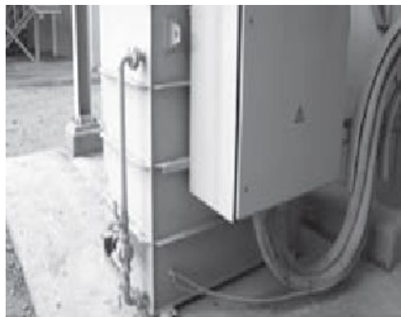
شکل 12 - نمایی از اتصالات کابل های استاتور
