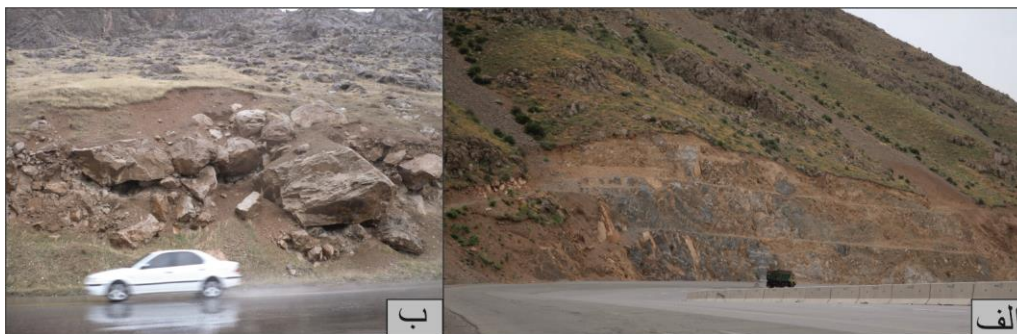
شکل ۷. پایدارسازی دامنه‌ها، الف: پلکانی کردن شیب و ب: بخش‌هایی که نیازمند لقی گیری فوری است.
