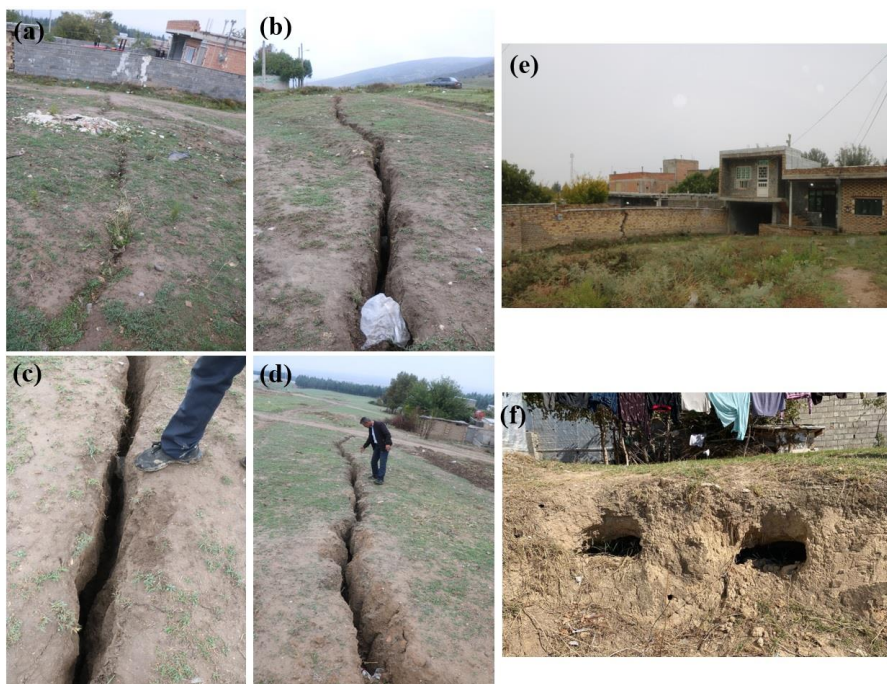
شکل ۲. نشست نامتقارن ساختمانهای مسکونی و ترک خوردن زمین در منطقه مورد مطالعه
