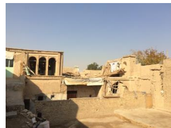
شکل (۵). نمایی از ساختمان های فرسوده محله جویباره (مأخذ: نگارنده)
