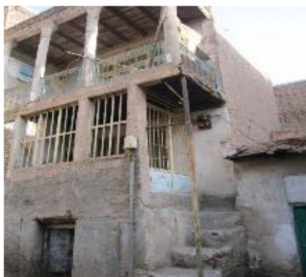
شکل 13- نمونه ای از ساختمان های مسکونی با مرمتی و تخریبی
